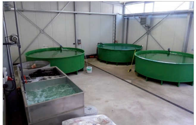
Kreislaufanlage in der Pilotanlage in Aßlar
